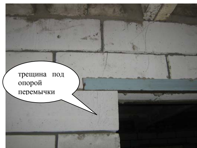
Рис. 1. Появление трещин в кладке из газосиликатных блоков под опорой перемычки
